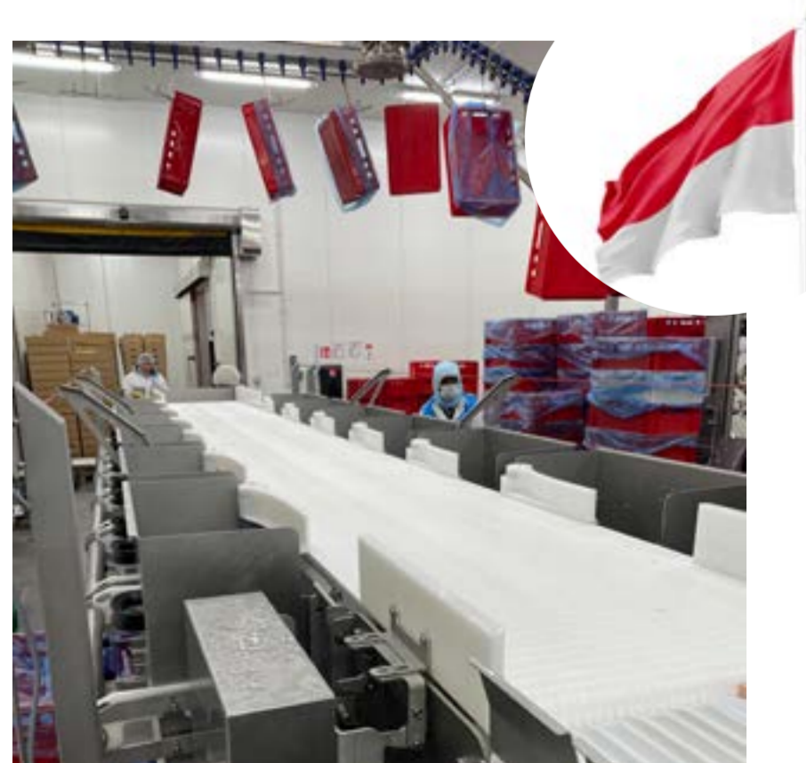
Installation et mise en service de notre calibreuse doseuse CALIBRA CD pour filets de poulets à Dulowa.
